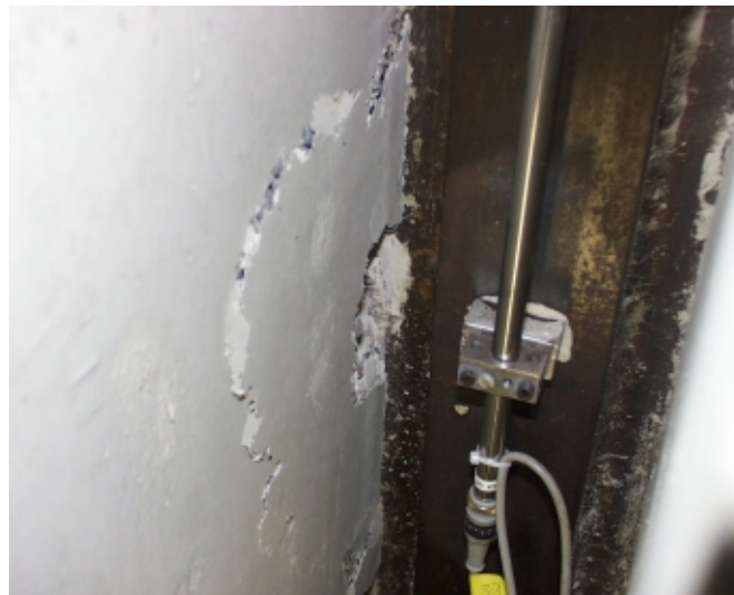
Bild 15 Schadensbild beim Versagen des Versuchskörpers ED1-K5 Fig. 15 Damage at failure of testspecimen ED1-K5
